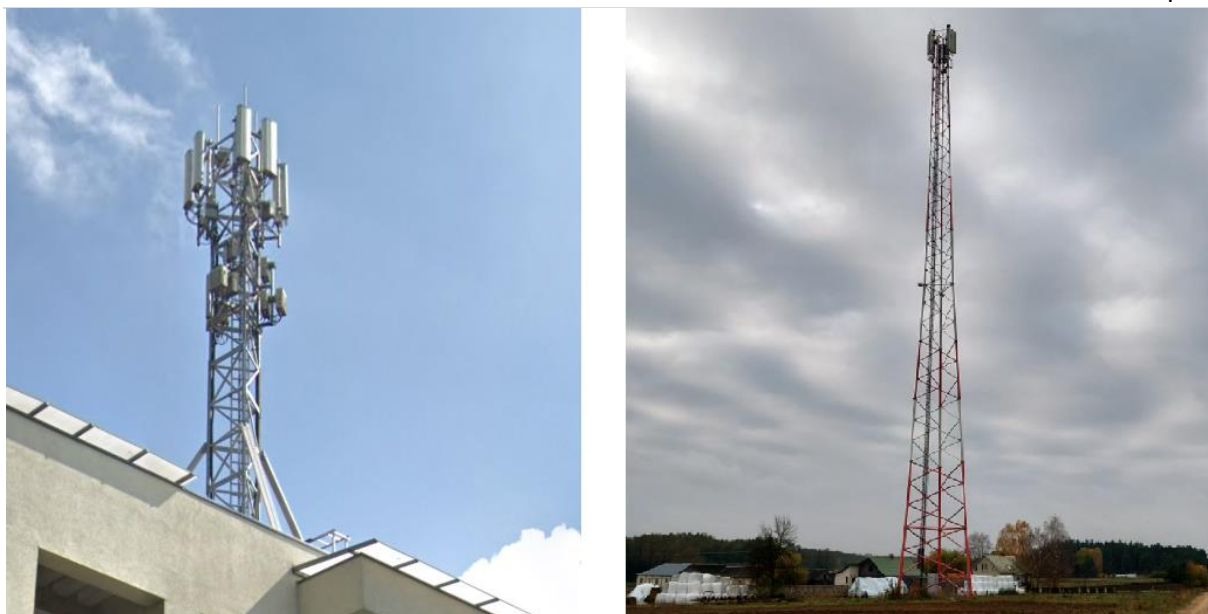
Rysunek 4. Stacje bazowe telefonii komórkowej na dachu budynku oraz wolnostojąca
